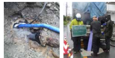
▲腐食した下水道管
