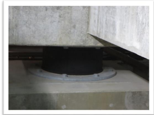
免震装置（福島県喜多方市役所）
